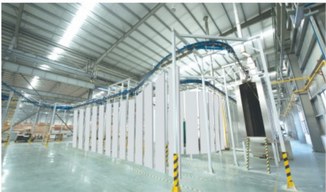
德国进口瓦格纳喷涂生产线
