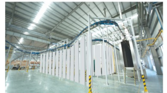
德国进口瓦格纳尔喷涂生产线
